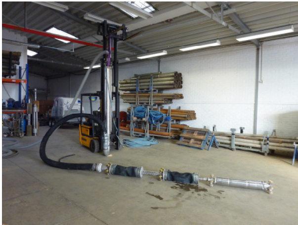
Abb. 4 HLE-Geräte hypop®, SDKK®-300.600 und gemantelte UWM-Pumpe für Filterstrangentwicklung des Horizontalbrunnens der Stadtwerke Weinfeld AG in Schachen/Schweiz.
